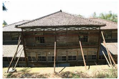
岡山県指定重要文化財旧吹屋小学校（成羽町吹屋） 本館は倒壊を防ぐため校舎裏を支柱で支えている
